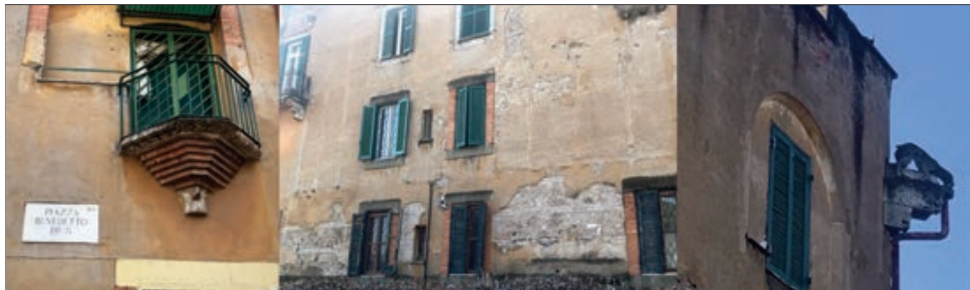
Lo stato di incuria dello storico stabile di piazza Benedetto Brin, primo nucleo abitativo del quartiere
