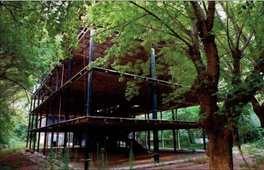
la vecchia scuola abbandonata su viale Tormarancia
